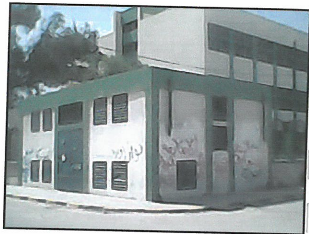
محطة توزيع كهرباء بجانب مدرسه
