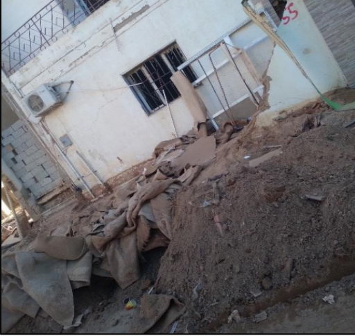
صورة (11) تظهر مبنى سكني وانهيأ أحد شرفات المنزل
